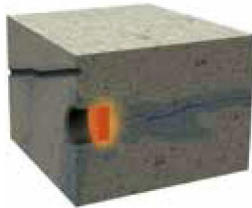
2) 使用 PENEPLUG 澎内传快速堵漏剂 (PNC602) 封堵冒水的孔洞部位, 快速止水。
